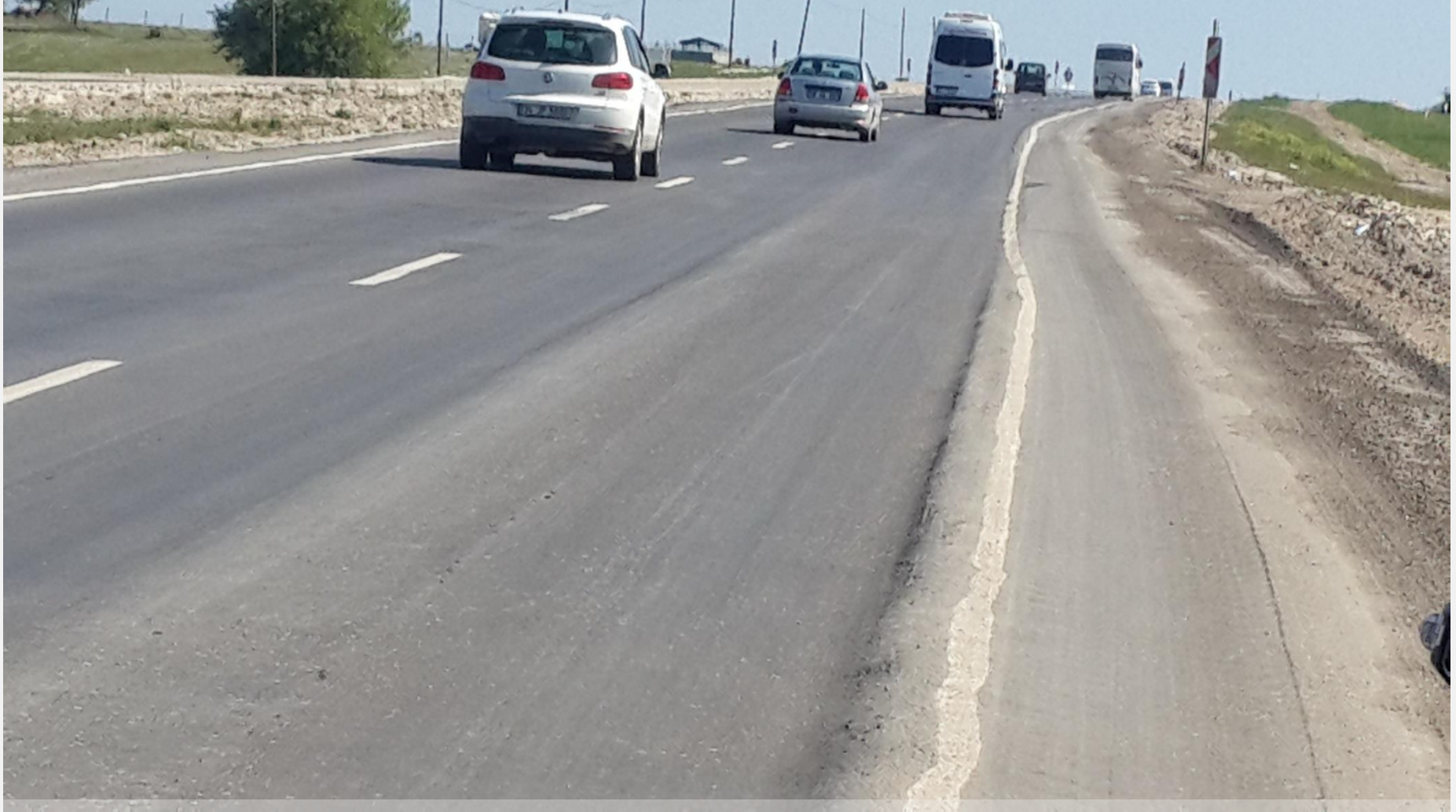
NovoCrete® Uygulama öncesi yolun durumu (20.04.2015)
