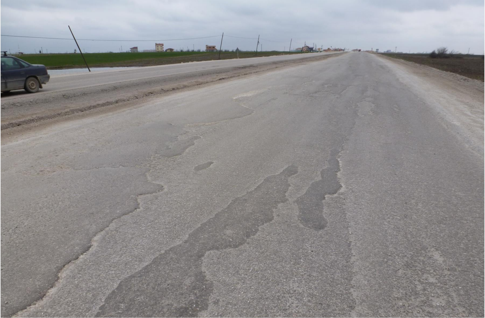
NovoCrete® Uygulama öncesi yolun durumu (24.03.2015)
