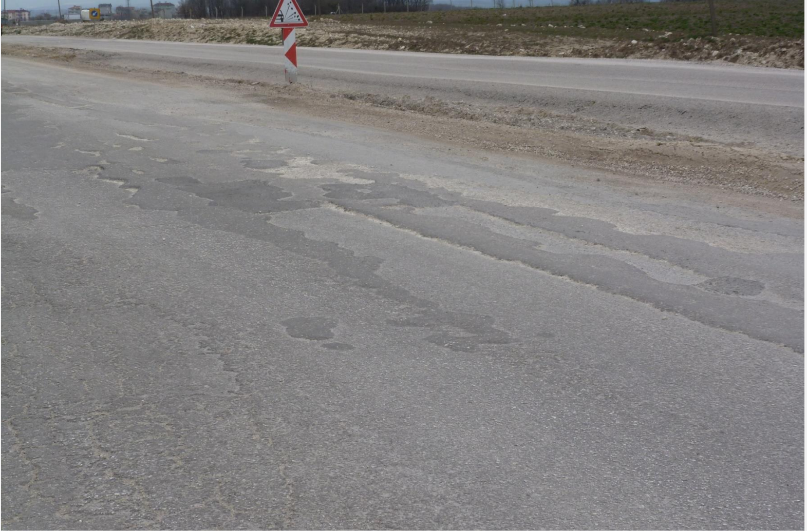
NovoCrete® Uygulama öncesi yolun durumu (24.03.2015)
