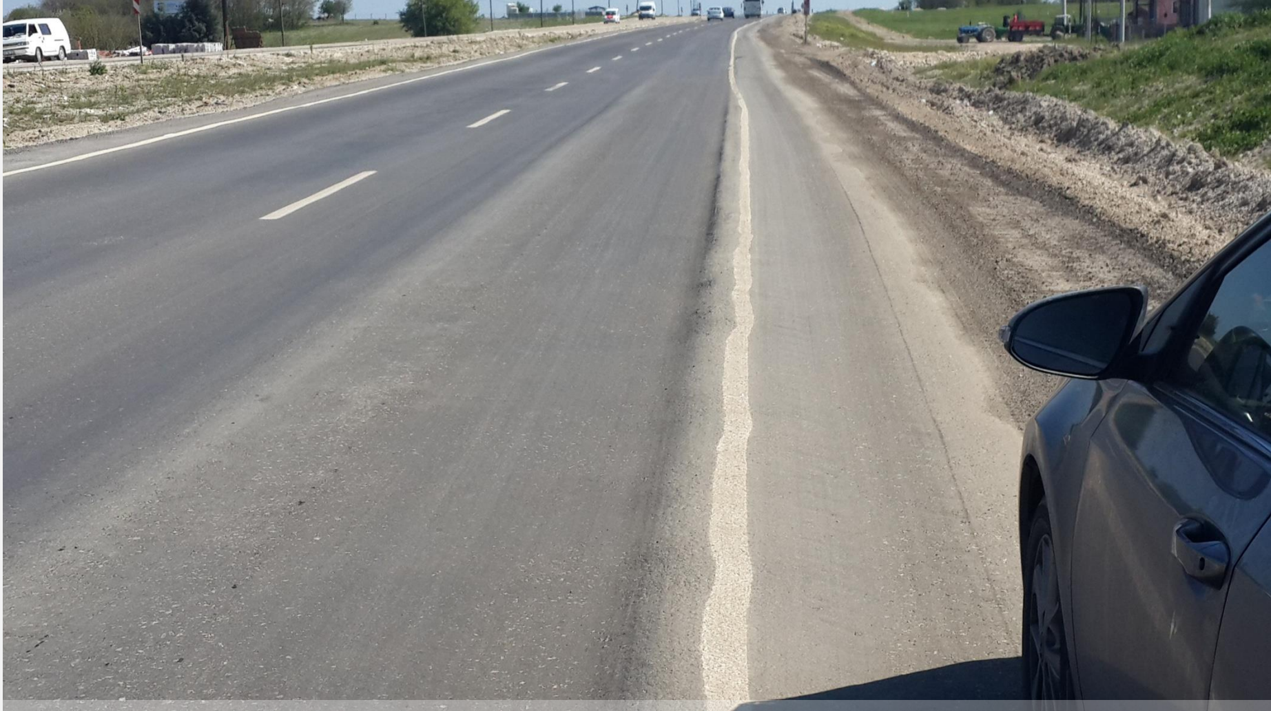
NovoCrete® Uygulama öncesi yolun durumu (20.04.2015)
